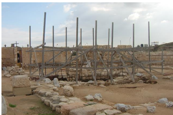
صورة (٢) تدهور موقع قبر القديس مينا مع قضبان الحديد والأخشاب الداعمة المصدر: الدراسة الميدانية
